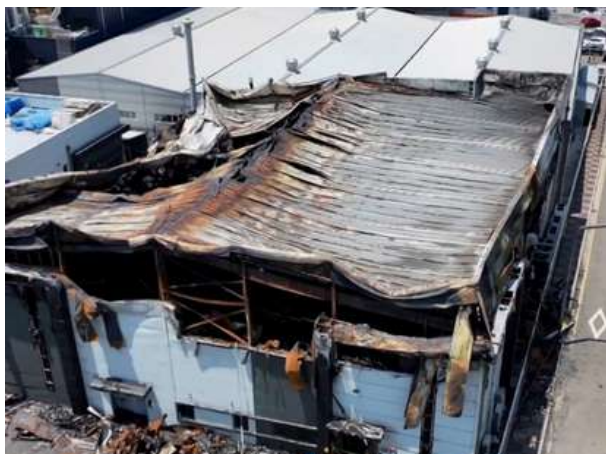
Daños estructurales observados después del incendio. Una emergencia con baterías no debe analizarse solo desde la extinción: también compromete continuidad operativa, infraestructura, investigación legal y reputación corporativa.
